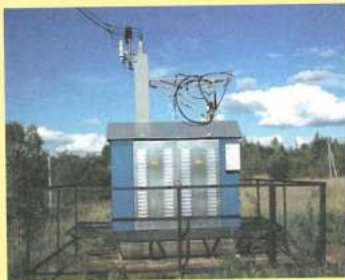
Un transformateur EDF en milieu rural
