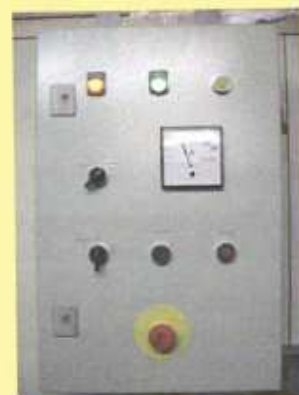
Une armoire électrique
