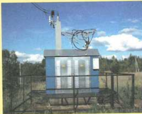
Un transformateur EDF en milieu rural
